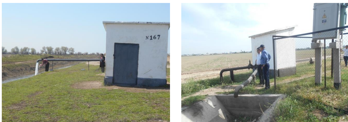
Рис. 1. Скважины вертикального дренажа
